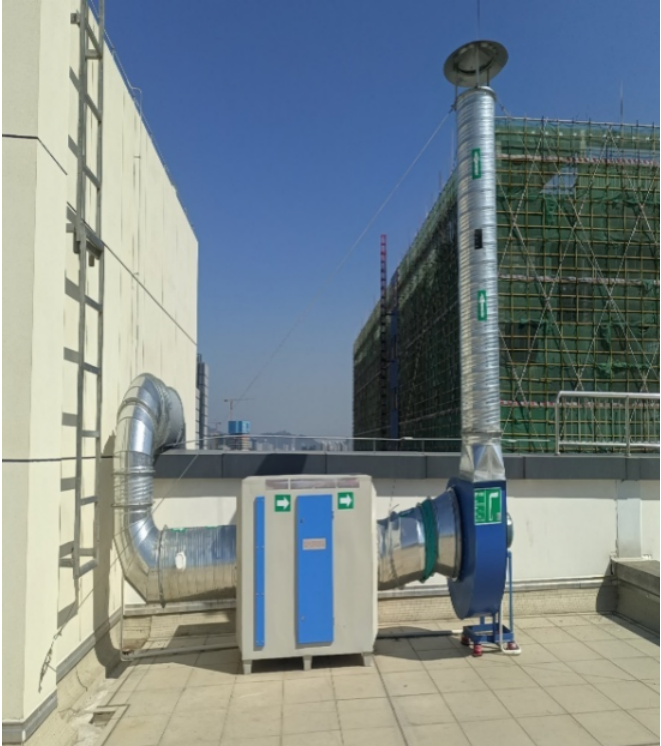
生产废气处理装置
