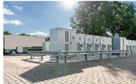
Estación de Carga para Flota Logística, Países Bajos Capacidad: 1.5MW / 3.2MWh Aplicación: Autoconsumo Solar, Servicios de Balanceo
