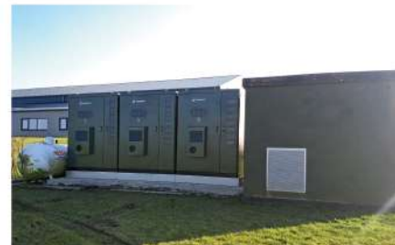
Granja Avícola, Bélgica Capacidad: 300kW / 645kWh Aplicación: Autoconsumo Solar, Servicios de Balanceo
