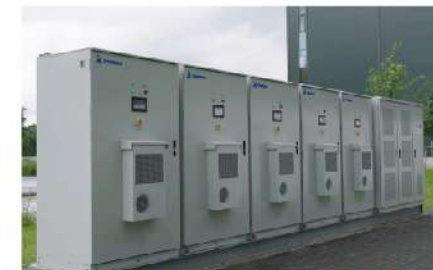
Centro de Distribución, Alemania Capacidad: 500kW / 1000kWh Aplicación: Autoconsumo Solar
