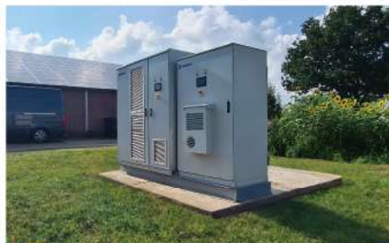
Granja Ganadera, Países Bajos Capacidad: 62.5kW / 215kWh Aplicación: Autoconsumo Solar, Servicio de Balanceo
