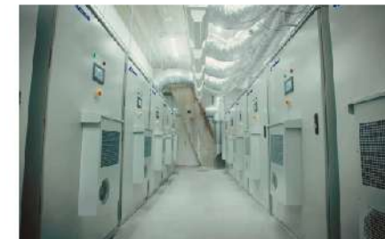
Estadio, Países Bajos Capacidad: 2MW / 5.59MWh Aplicación: Recorte de Picos
