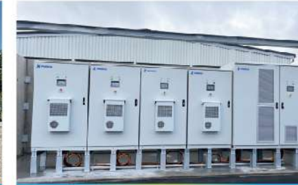
Fábrica de Procesamiento de Acero, Suecia Capacidad: 500kW / 860kWh Aplicación: Regulación de Frecuencia
