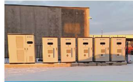
Empresa de Alquiler de Equipos, Noruega Capacidad: 500kW / 1075kWh Aplicación: Recorte de Picos, Servicios de Balanceo
