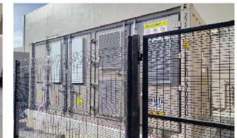
Centro Comercial, Sudáfrica Capacidad: 375kW / 860kWh Aplicación: Energía de Respaldo
