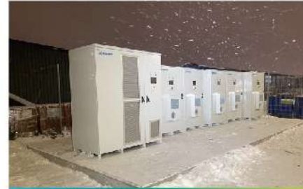
Estación de Carga para VE, Suecia Capacidad: 500kW / 1075kWh Aplicación: Servicios de Balanceo
