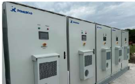
Granja Porcina, Países Bajos Capacidad: 1.5MW / 3MWh Aplicación: Servicios de Balanceo
