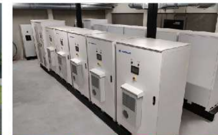
Almacén de Equipos de Camping, Países Bajos Capacidad: 1MW / 2.15MWh Aplicación: Autoconsumo Solar
