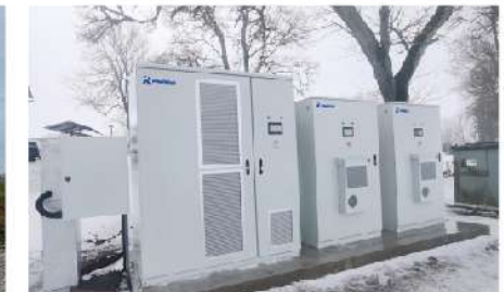
Suecia Capacidad: 187.5kW / 430kWh Aplicación: Regulación de Frecuencia
