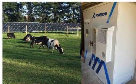
Granja Lechera, Nueva Zelanda Capacidad: 60kW / 122.88kWh Aplicación: Aislado de la Red, Autoconsumo Solar
