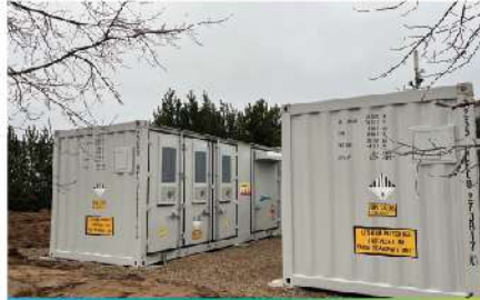
Fábrica de Paneles FV, Lituania Capacidad: 1000kW / 2580kWh Aplicación: Autoconsumo Solar, Recorte de Picos
