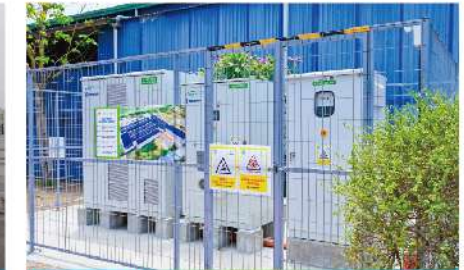
Fábrica de Lubricantes para Motores, Vietnam Capacidad: 100kW / 215kWh Aplicación: Autoconsumo Solar
