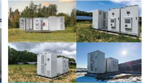
Planta de Energía FV, República Checa Capacidad: 7MW / 12.47MWh Aplicación: Autoconsumo Solar
