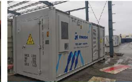
Fábrica de Equipos Eléctricos, México Capacidad: 187.5kW / 648kWh Aplicación: Autoconsumo Solar
